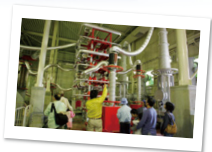
JT-60 N-NBI電源設備
