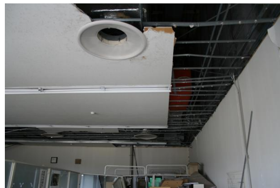
付属実験棟の天井パネルの一部落下
