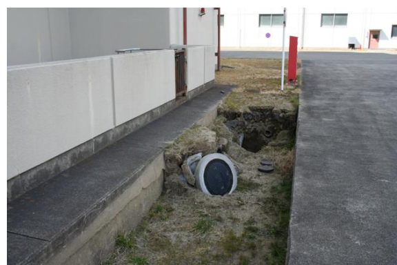
JT-60実験棟まわりの一部陥没
