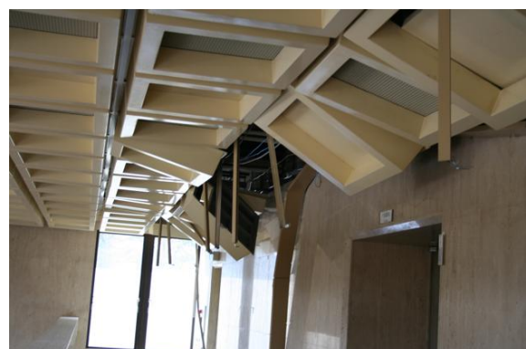
制御棟ロビーの天井板の一部落下
