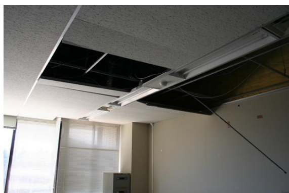
管理研究棟内部の天井パネル一部落下
