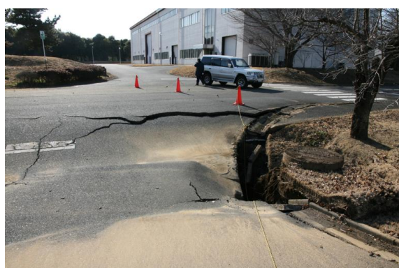
構内道路の陥没
