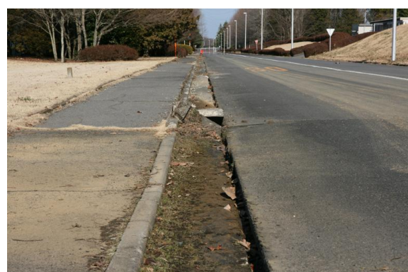
構内道路の陥没
